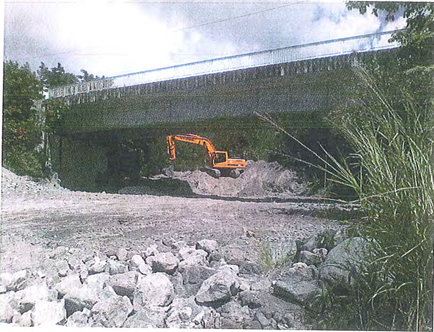
Pont de la rivière sèche les engins chargés du curage peuvent toucher la conduite passant dans la rivière
