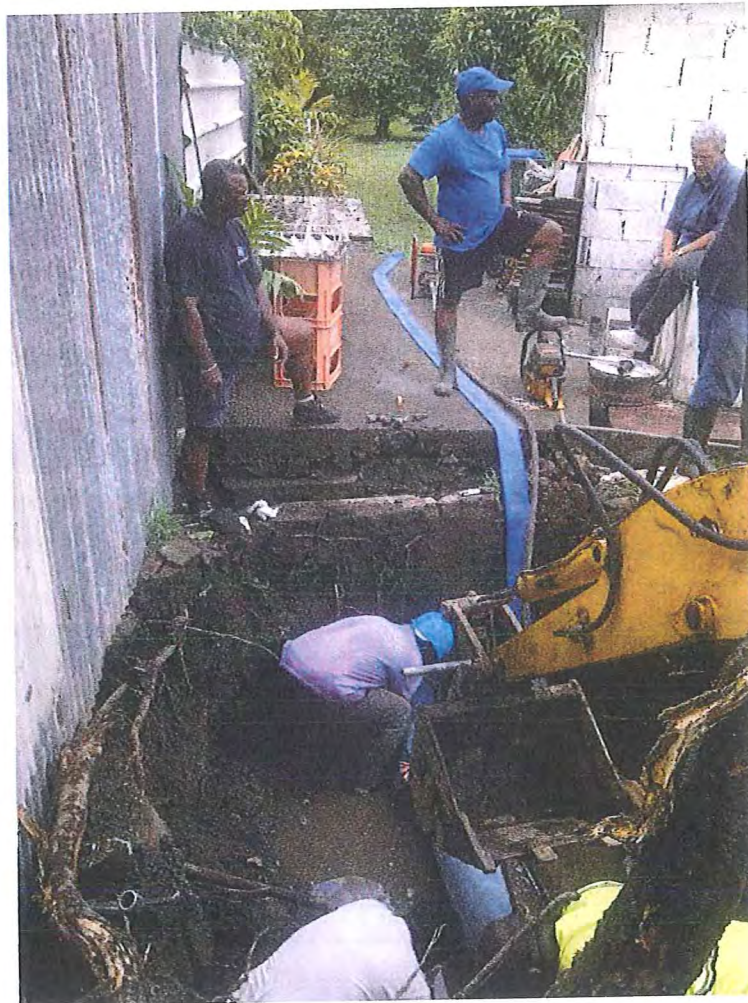
Casse du 31 juillet 2011 chez la famille DONGARD d'une conduite en fonte de 200 mm alimentant le CARBET
