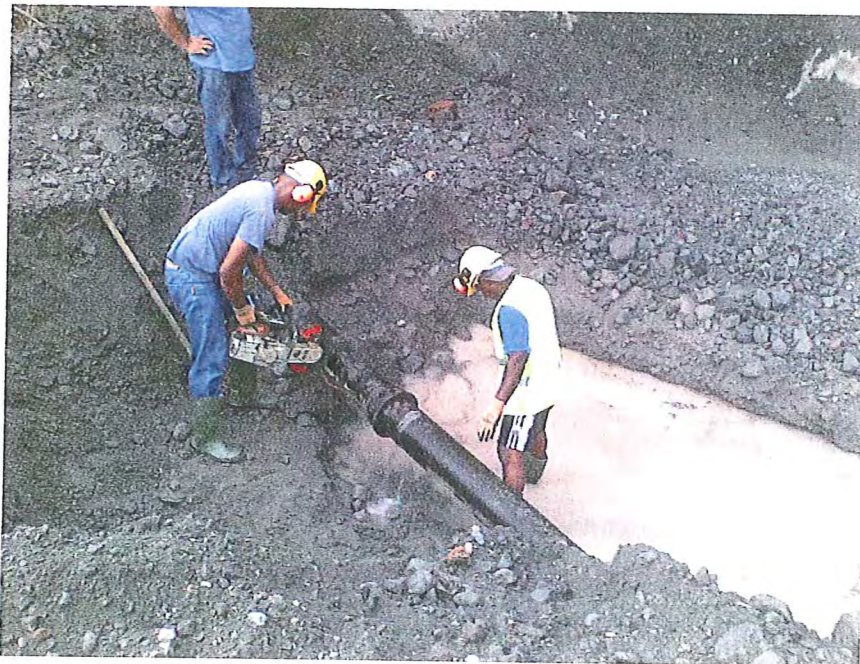
Réparation de la casse sur la conduite d'alimentation du PRECHEUR dû à l'engin chargé du curage.
